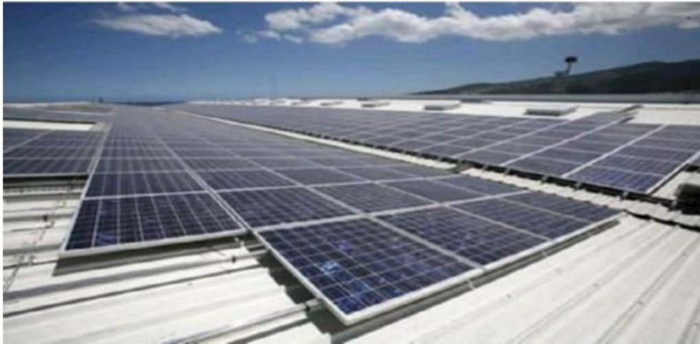
Figure 5: photo d'une centrale solaire [2]
