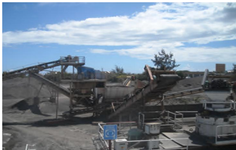
Figure I.7 : Station de traitement des granulats.
