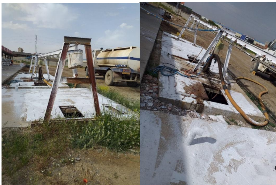
Photo 2 : Les bassin de Décantation
