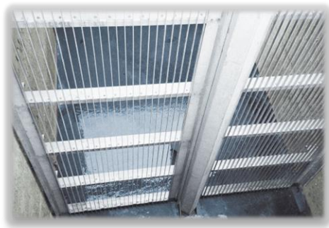
Figure 1 : le Dégrillage grossier (Banzaoui et Elbouz, 2009).
