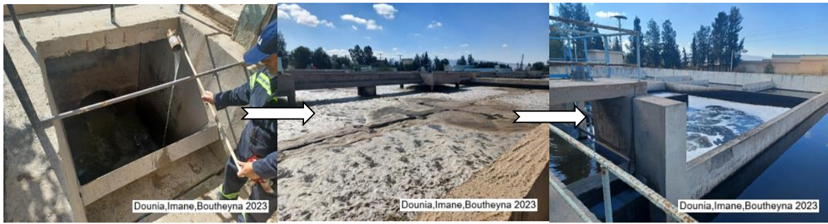
Figure 8 : Étapes d'épuration des eaux usées dans la station de BBA (Avant, durant et après l'épuration)
