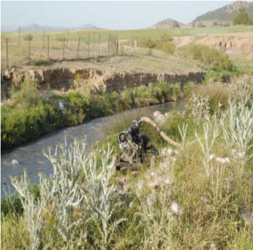
Photo1. Pompage des eaux usées polluées pour l’irrigation des parcelles.
