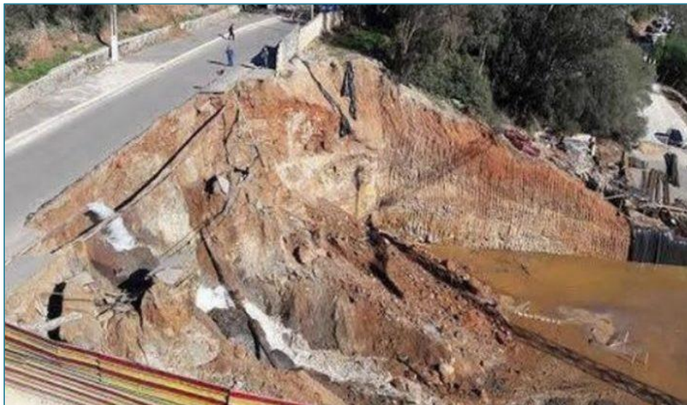
Figure 9 : route coupée à Bouzaréah après un glissement de terrain (Amoura et Maameri 2014).
