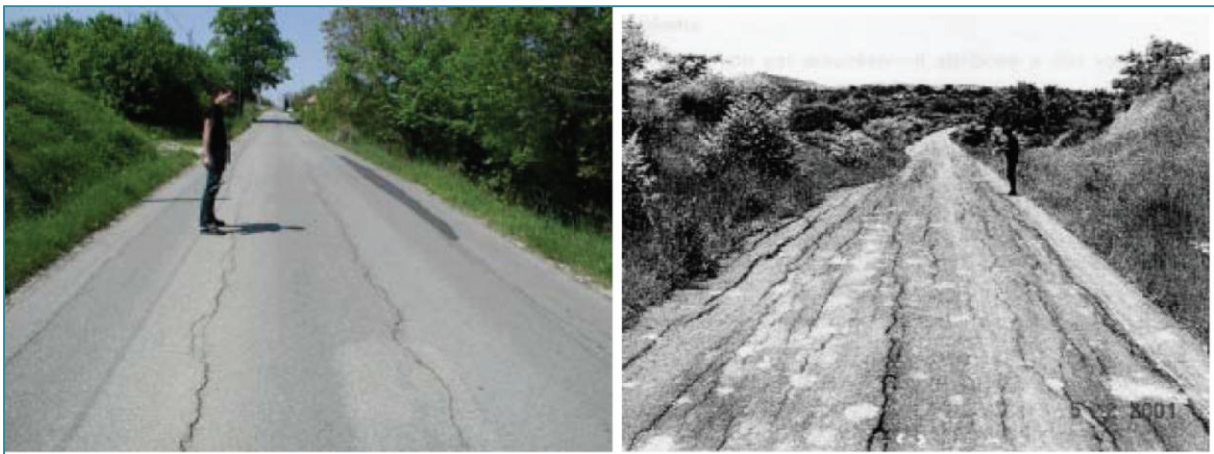
Figure 6: Fissuration longitudinale de routes due au retrait et gonflement des sols (Amoura et Maameri 2014)
