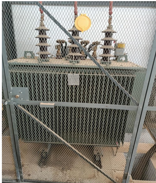
Figure 22 Poste d'intérieur HT/BT (station de pompage Zada)
