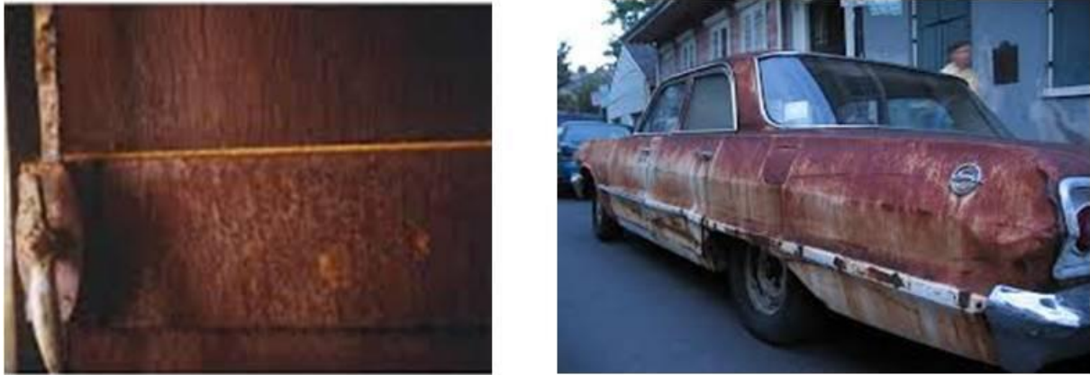
Figure I.3 : Corrosion généralisée / exemple d'une porte et d'un véhicule corrodés [8].
