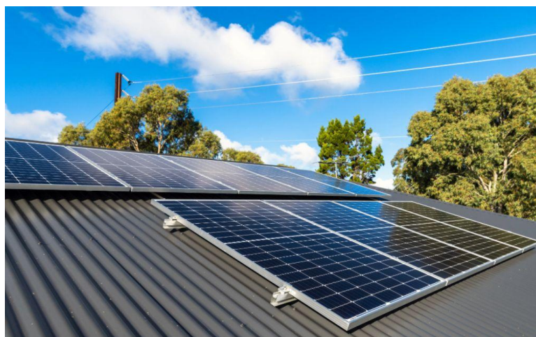
Figure 1.12 - les panneaux solaires photovoltaïques [27]
