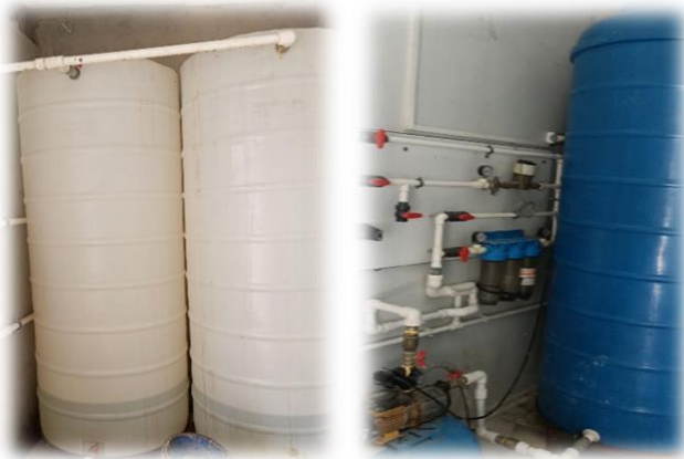
Figure 20: Réservoir d'eau – E1 et E2 (photo originale,2025)
