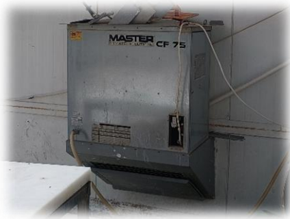
Figure 14: Système de chauffage automatique, bâtiment B1 (photo originale,2025)
