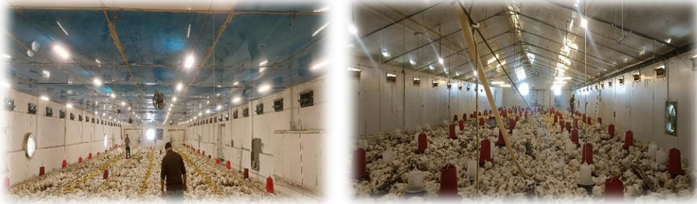
Figure 21: Système d'éclairage – B1 et B2 (photo originale,2025)
