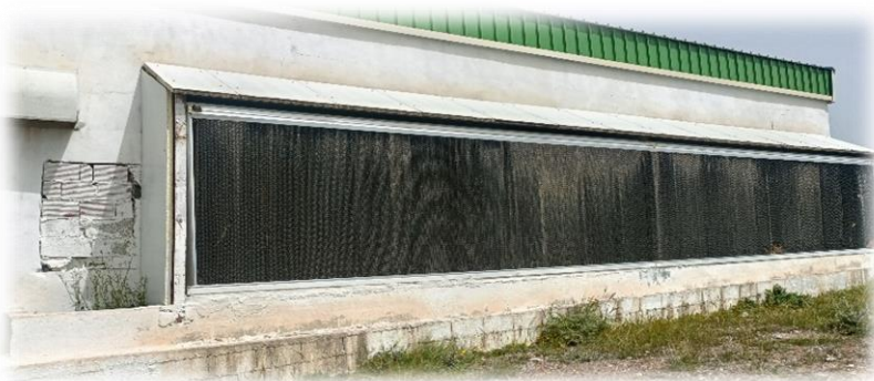
Figure 11: Système de Pad_Cooling dans le bâtiment E1 (photo originale, 2025)
