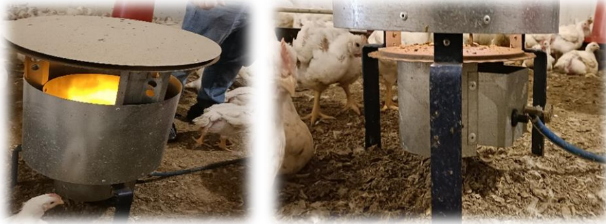
Figure 13: chauffage au gaz, bâtiment E2 (photo originale,2025)
