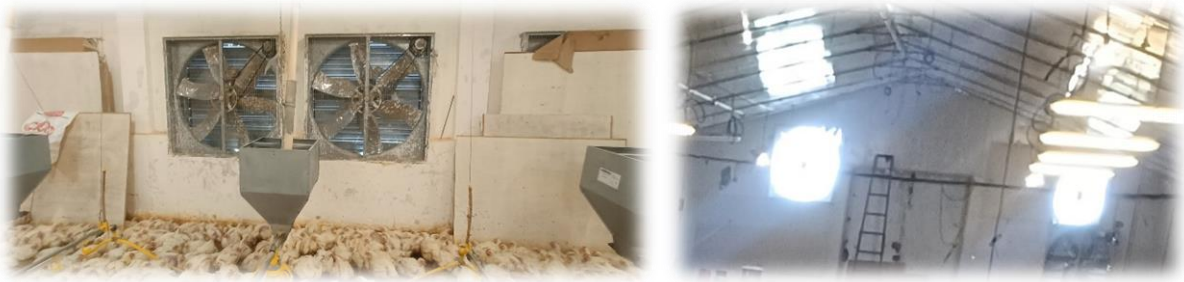
Figure 10: Les extracteurs bâtiment B01 et bâtiment B02 (photo originale, 2025)
